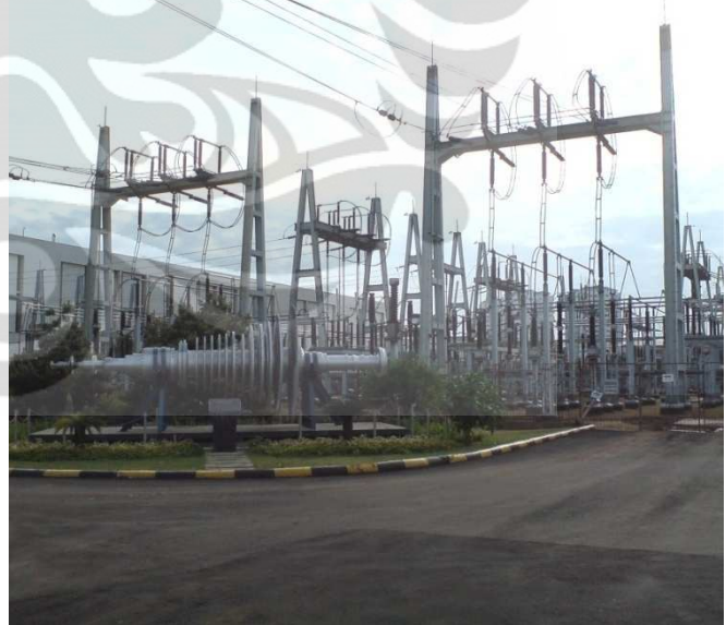
Foto 4. Switch Yard Area di PLTU
