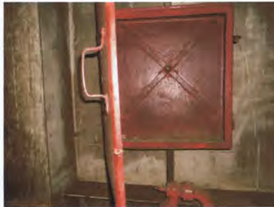
Gambar. 1.3 Selang pemadam kebakaran tidak tersedia
