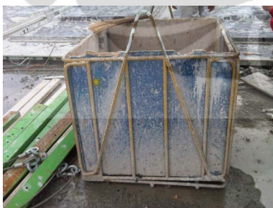
Kontainer Penampungan Limbah Beton Sisa Bobokan
