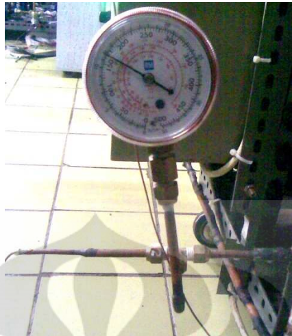
Gambar 3. 14 Pressure gauge yang digunakan dalam sistem.
