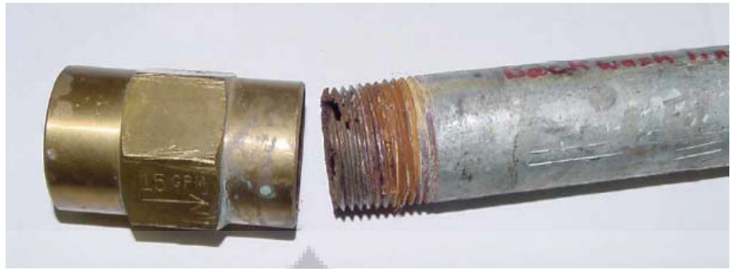
Gambar 2.4.4 Contoh bentuk korosi galvanic pada sambungan ulir antara fitting kuningan dengan pipa baja karbon 49
