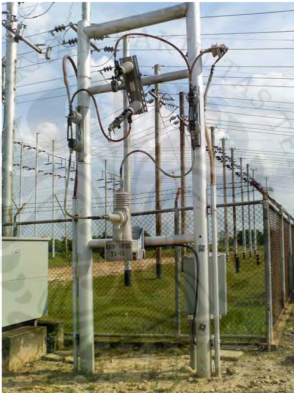
Lampiran 1 Foto GFPC Terpasang Pada Gardu Induk
