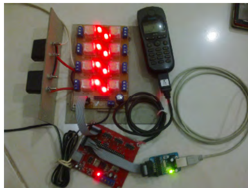
Gambar 3.7. Peralatan yang sudah Terhubung Lengkap
