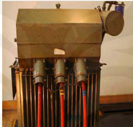
Gambar 2.2. Trafo Pemakaian sendiri
