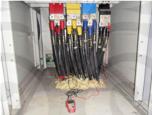
Gambar Pengukuran Pada Outgoing Trafo
