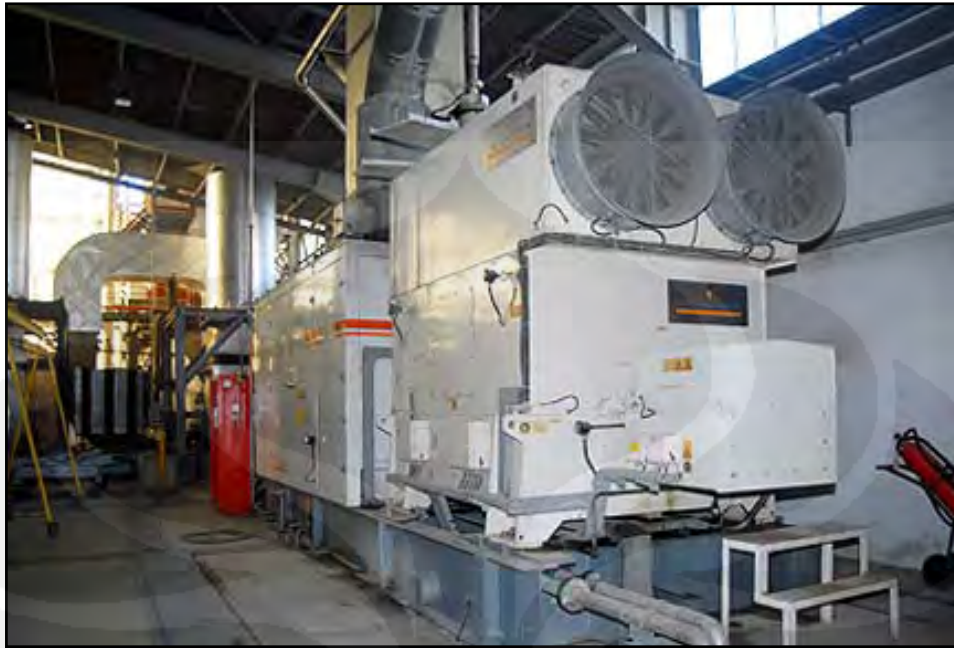
Gambar 2.3. Turbin gas dan Generator EGT – BS 5000
