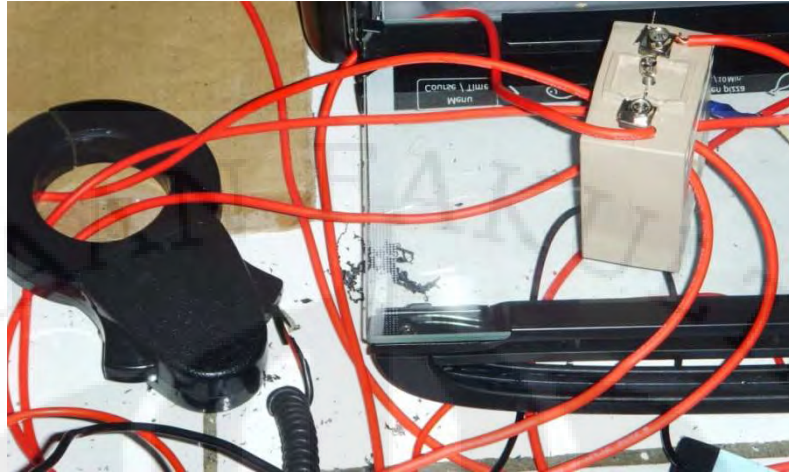
Gambar 3.6. Kabel yang dililitkan pada Trafo arus
