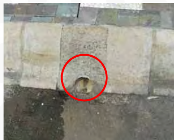
Gambar 3.17. Lubang Air Menuju Saluran Air Kotor pada Jalan (sumber: dokumentasi pribadi)
