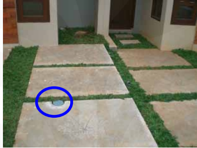
Gambar 3.38. Lubang Udara Septic Tank pada Car Port (sumber: dokumentasi pribadi)
