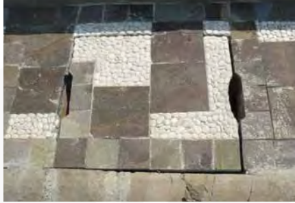
Gambar 3.20. Bak Kontrol Saluran Air Kotor (sumber: dokumentasi pribadi)
