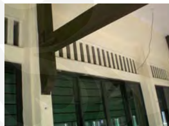
Gb.4.21. Ventilasi di Departemen Arsitektur
