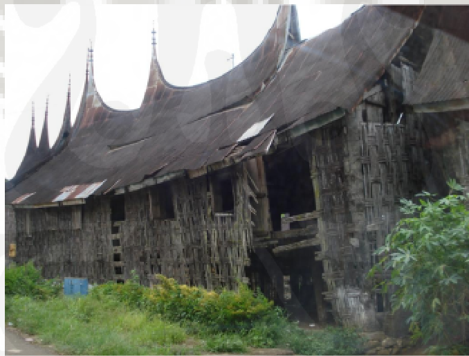
Gambar 5.52 Rumah gadang yang sudah tidak dihuni, dibiarkan lapuk termakan usia
