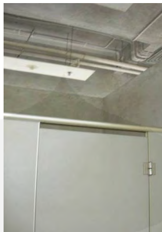
Gambar 3.50 Dinding toilet tidak menyentuh Celling (Sumber: Dok.
