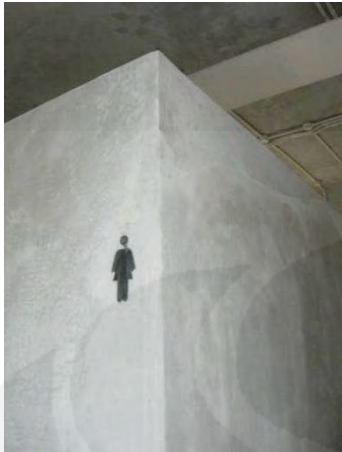
Gambar 3.49 Dinding toilet tidak menyentuh Celling (Sumber: Dok. Pribadi)
