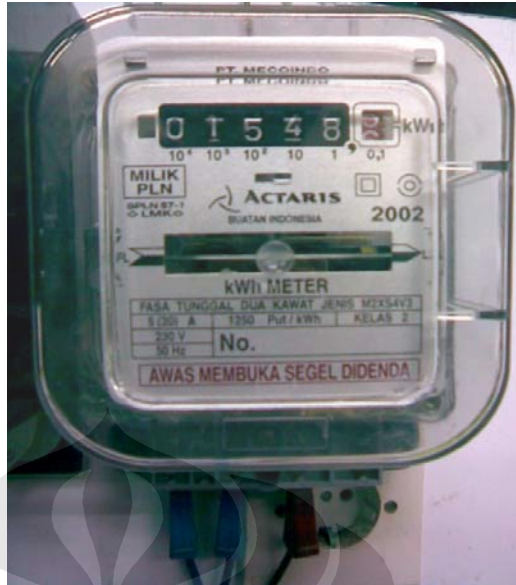
Gambar 3.3 KWh-meter satu fasa Actaris
