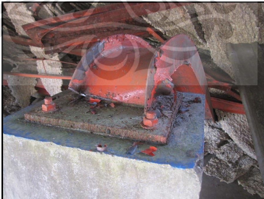
Gambar 4. 10 Foto keruntuhan kolom pada lantai dasar
