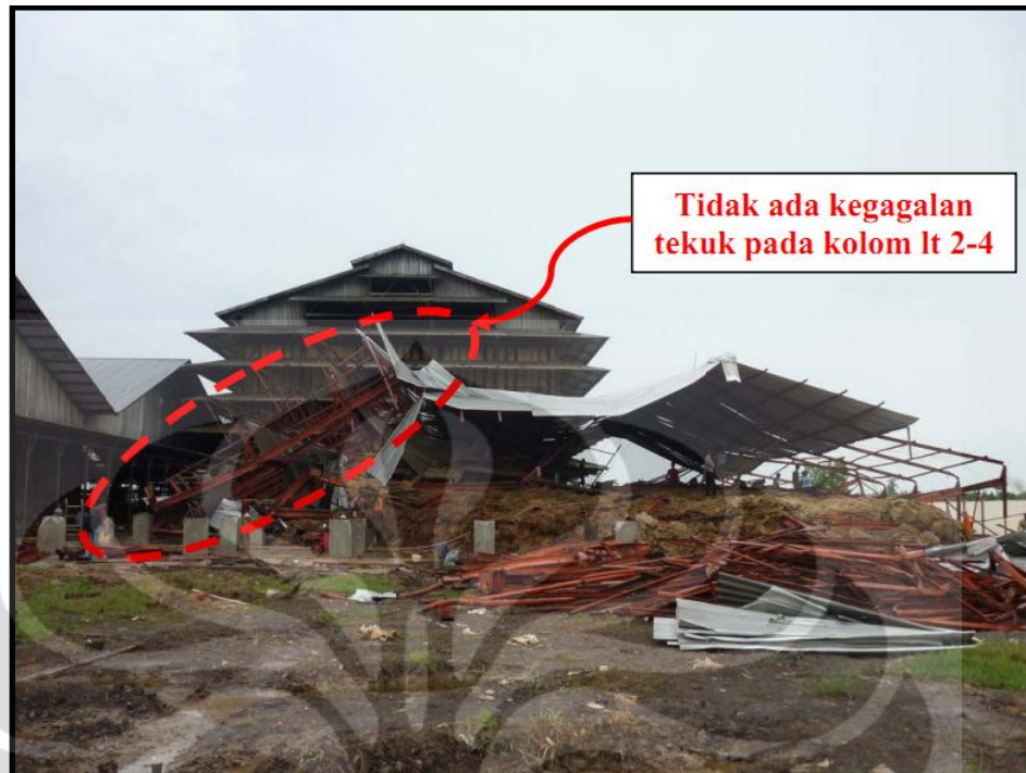
Gambar 4. 7 Foto kegagalan tekuk pada kolom pinggir untuk portal dalam
