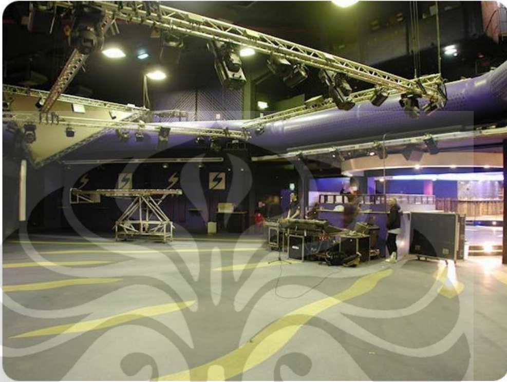
Gambar 2.1 Penggunaan textile ducting pada Loughborough University
