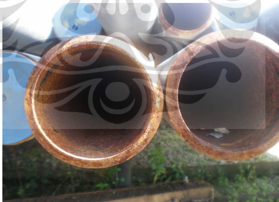
(d) Kondisi pipa yang mengalami korosi pada bagian permukaan dalam
