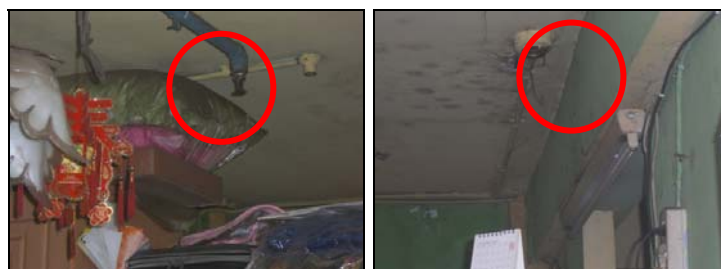
Gambar 3.12. Perangkat Pencegah Kebakaran pada Unit
