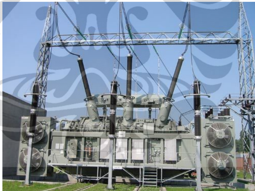
Gambar 2.2 Bushing pada Terminal Transformator
