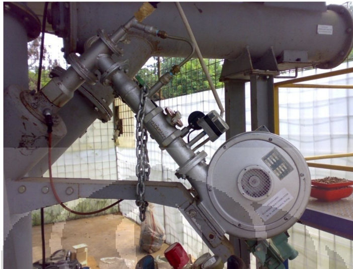
Gambar 2.16 Burner yang digunakan pada Fluidized Bed Combustor UI
