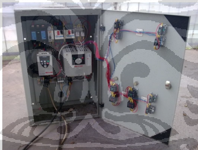
Gambar 3.9 Control panel yang digunakan untuk feeder dan blower
