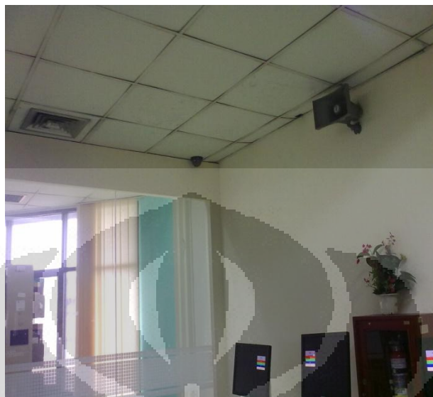
Gambar Kamera CCTV
