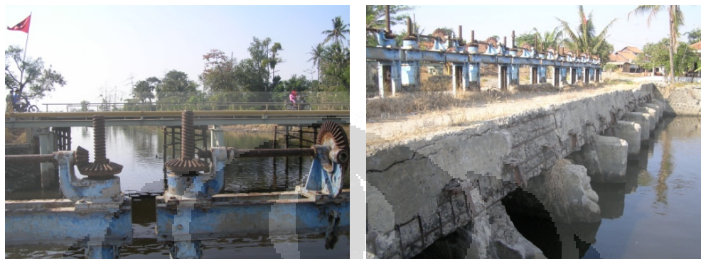
Gambar 2.2. dan 2.3 Kondisi pintu air di Kecamatan Cantigi yang terbengkalai
