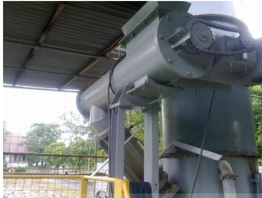
Gambar 3.9 Sistem feeder pada fluidized bed combustor UI
