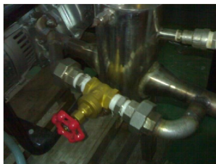
Gambar 3.15, Sistem Bypass Pada Gas Buang
