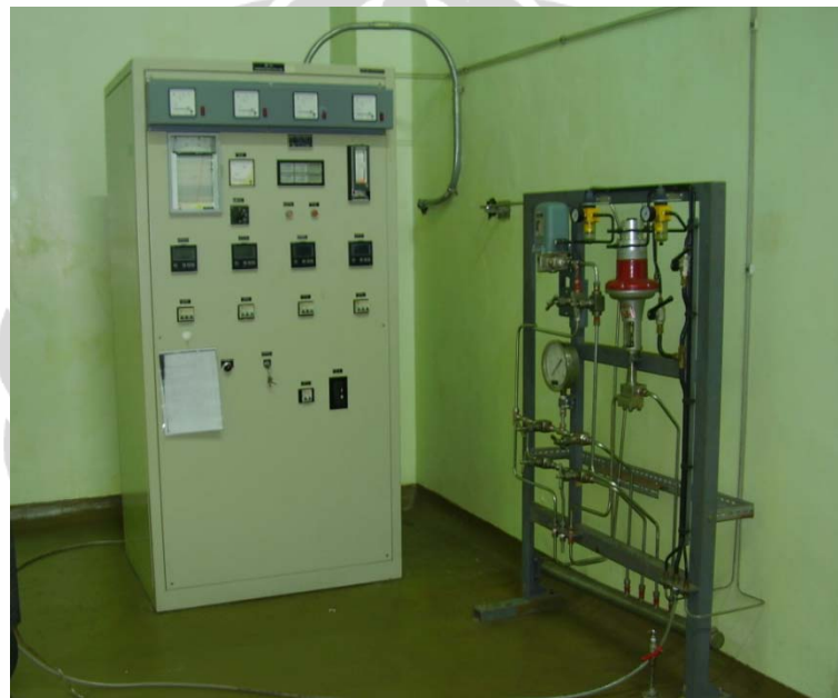
Gambar 2.5. Panel sistem elektrik tungku autoclave
