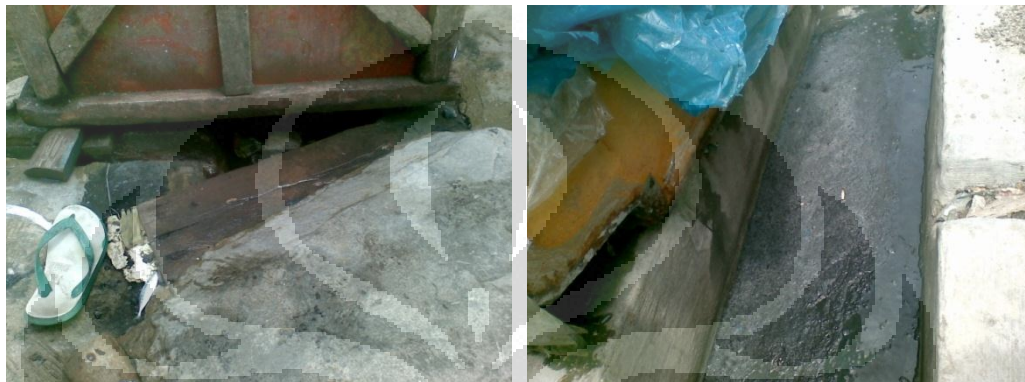
Gambar 6.4 dan 6.5. Saluran Pembuangan Air Limbah di Tempat Pelelangan Ikan Lempasing Teluk Betung, Bandar Lampung Tahun 2011
