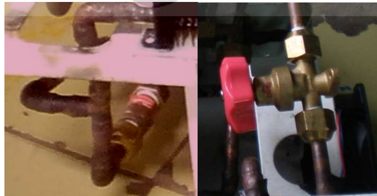
Gambar 3.9 Check Valve (katup satu arah) dan hand valve dari AC presisi
