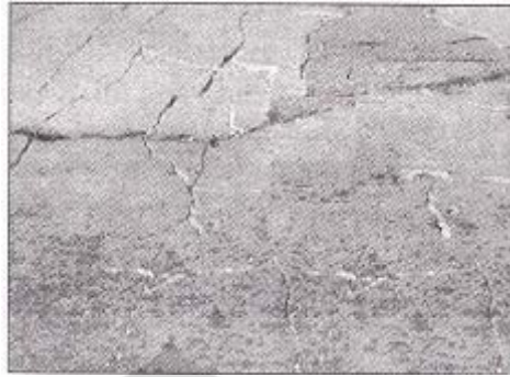
Gambar 2.13 Retak Bersilangan Pelat Pecah
