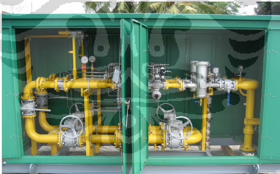
Gambar 2.5 MRS (Metering Regulating Station) instalasi turbine meter sesuai dengan rekomendasi dari AGA report No.7
