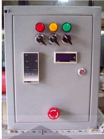
Gambar 0.14 Panel Sistem Listrik
