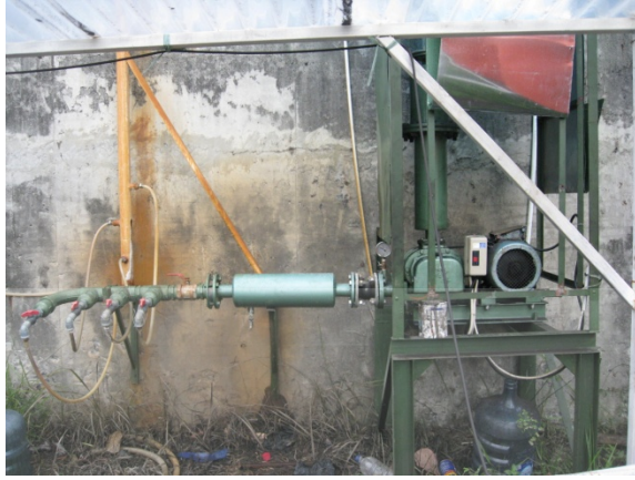
Pompa dan blower untuk menghisap emisi CO 2 dari cerobong PLTU
