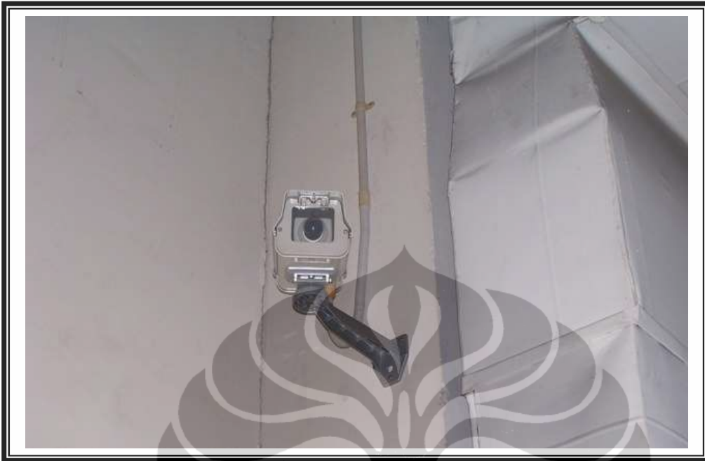
7. Salah satu kamera CCTV yang terpasang di areal parkir
