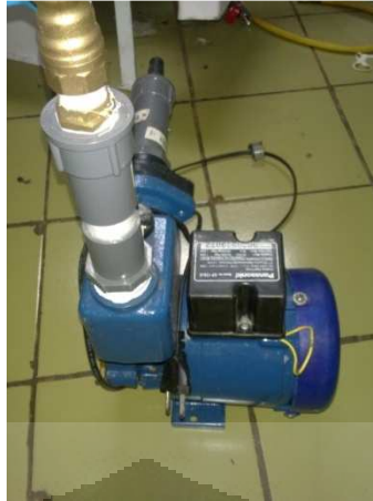
Gambar 3.6 Pompa sirkulasi air
