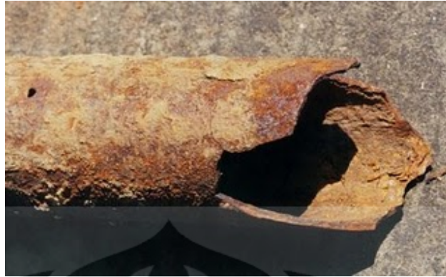
Gambar 2.1. Pipa yang mengalami korosi.
