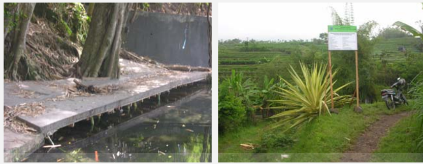
Pembangunan unit perlindungan mata air berupa bangunan konstruksi reservoir (brouncuptering) di Desa Pandanrejo
