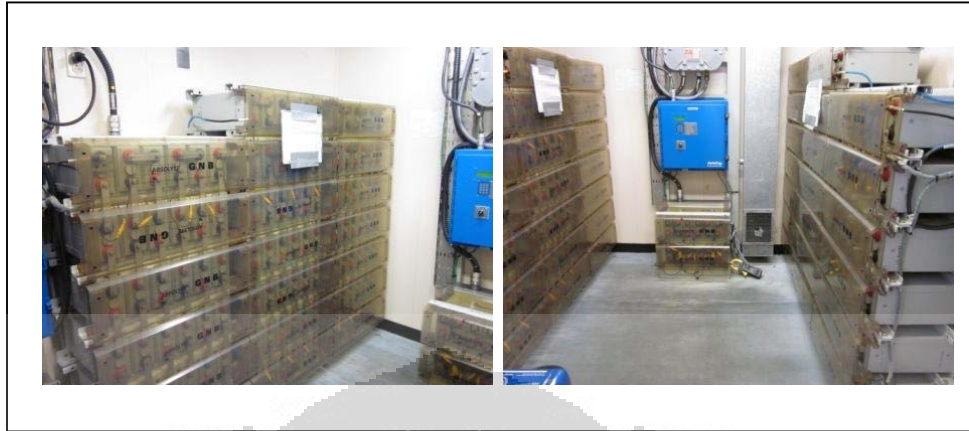
Gambar 4.10. Ruang penyimpanan battery untuk unit pemasok listrik tanpa jeda ( uninterruptible power supply – UPS )
