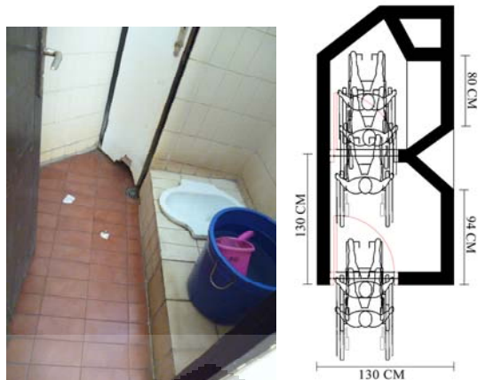
Gambar 3.16 Kondisi toilet gedung B (kiri)
