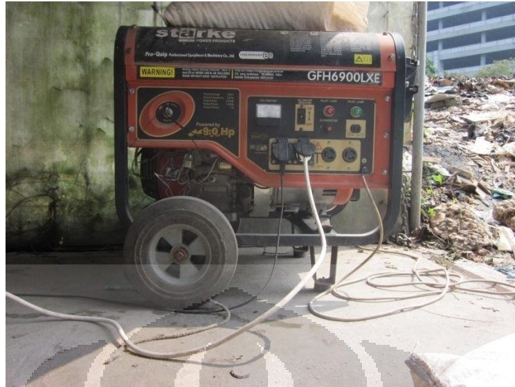
Gambar 3.4 Generator set yang digunakan
