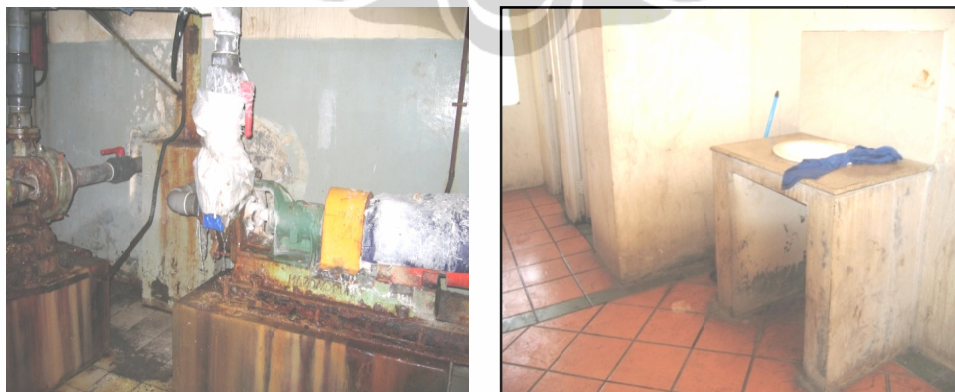
Gambar: 5.3 Kodisi Lingkungan Kerja Yang Tidak Dirawat
