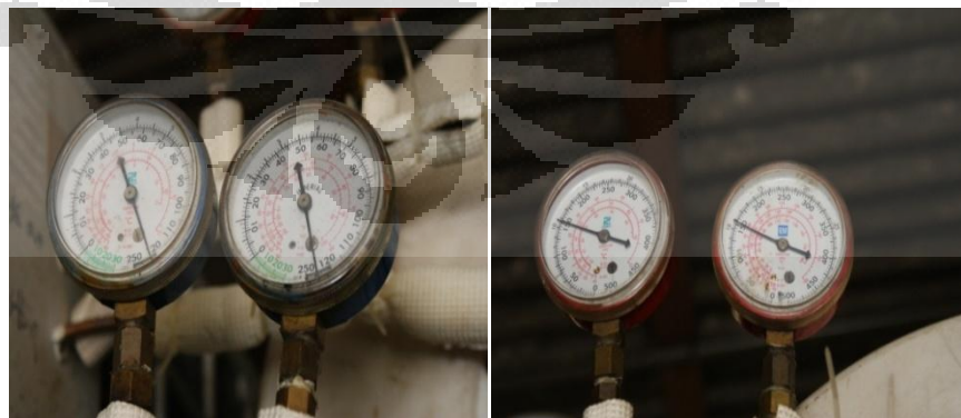
Gambar 3.29 (a) Pressure gauge pada evaporator in dan out (b) Pressure gauge pada alat penukar kalor in dan out
