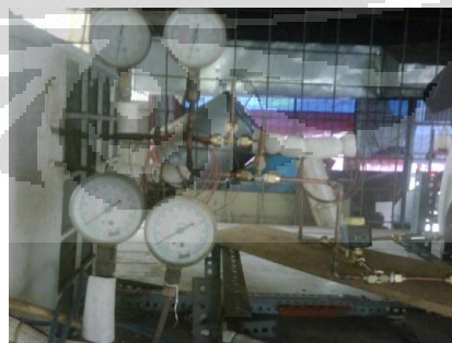
Gambar 3.20 Modifikasi pipa refrigeran AC pada S-ACWH
