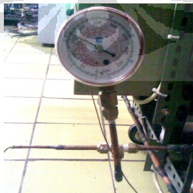
Gambar 3. 7 Pressure gauge yang digunakan dalam sistem.
