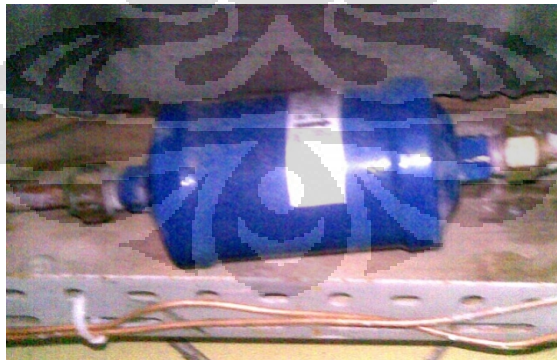
Gambar 3. 1 Filter dryer yang digunakan pada sistem ice slurry generator .
