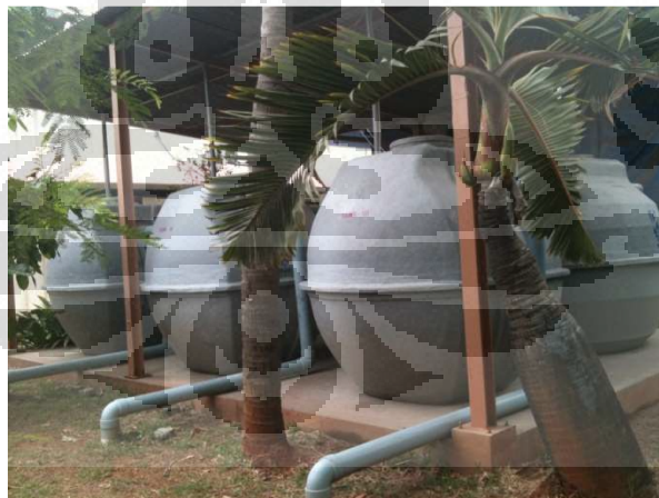
Gambar 1.2 STP Gedung Locker
