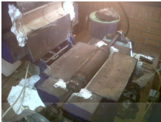
Gambar 3.38 Proses dry sorbent dan control panel untuk menjaga temperatur
