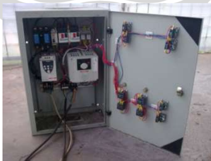
Gambar 3.11 Control panel yang digunakan untuk feeder dan blower dorong
