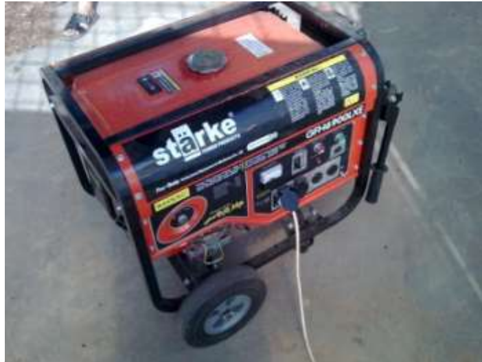
Gambar 3.6 Generator set yang digunakan
