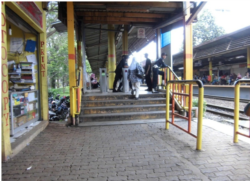
Gambar 4.6 Tangga Peron Stasiun UI yang Tidak Dilengkapi Ramp
