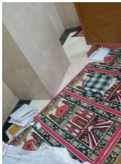
Gambar 3.65 Dinding Mushola yang Tidak Sesuai Arah Kiblat
