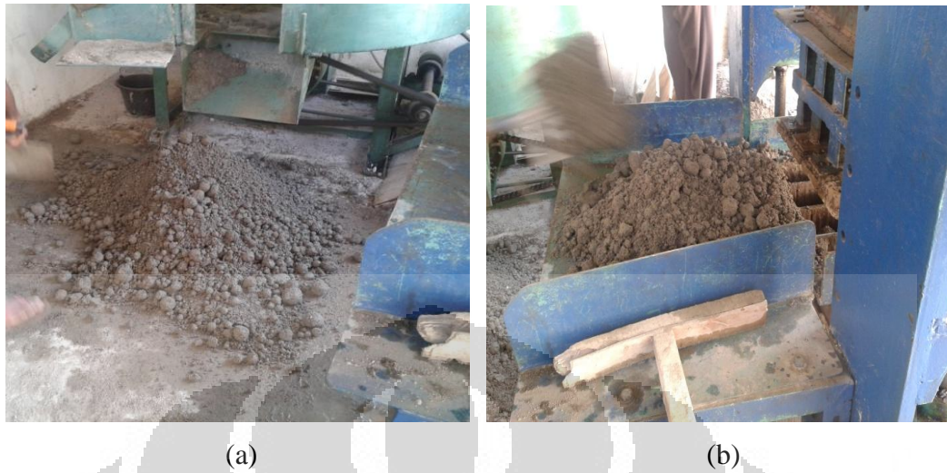
Gambar 7. (a) Campuran Paving Block yang Telah Diaduk (b) Campuran Paving Block Siap Dicetak
