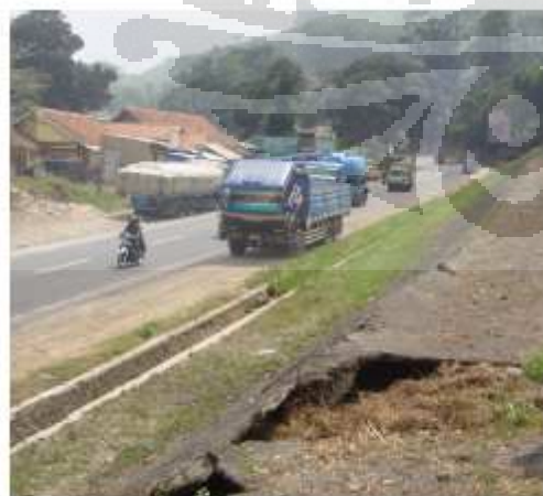
Gambar 9. Lubang pada lereng rekayasa (Foto: Zakaria, 2009).
